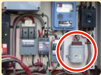
低圧分電盤内の低圧コンデンサー
