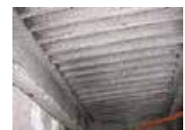
アスベスト含有吹付け ロックウール (鉄骨材の耐火被覆)
