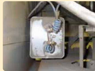
電気溶接機の内部に取り付けられた低圧コンデンサー
