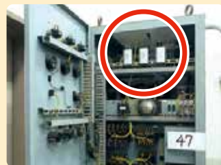
可変周波数電源装置に取り付けられた低圧コンデンサー
