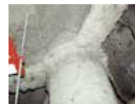
吹付けアスベスト (鉄骨材の耐火被覆)
