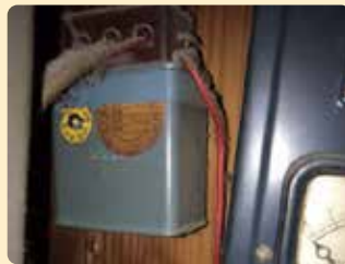
配電盤に設置された低圧コンデンサー
